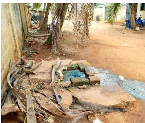
Fosse septique et rejet des boues de vidange dans la rue
