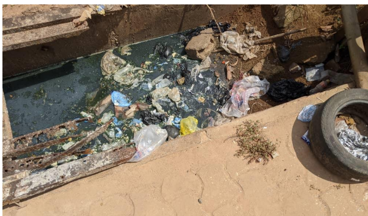
Planche 12: Caniveau mal entretenu dans le quartier Attiégouvi
